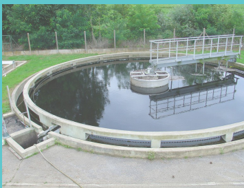
Station d'épuration de Stutzheim-Offenheim
